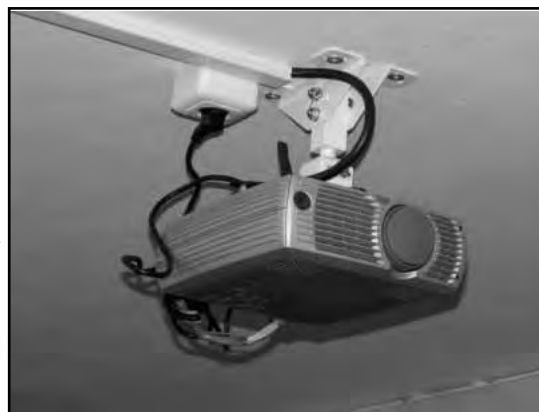
Projektor an der Decke im Unterrichtsraum
